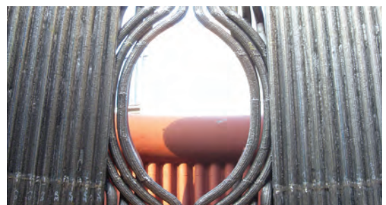
360° geschweißte Rohre mit Ausbiegungen
