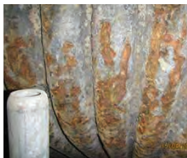
Rauchgasseitige Korrosion in einem kohlebefeuerter Kessel
