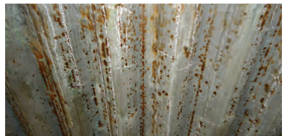
Rohrwand nach Kupfersulfattest
