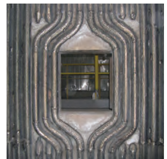
Apertura fabricada con tubos en espiral
