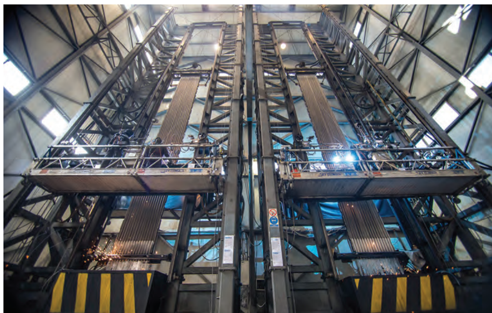
Allungamento della vita utile dei pannelli delle caldaie
