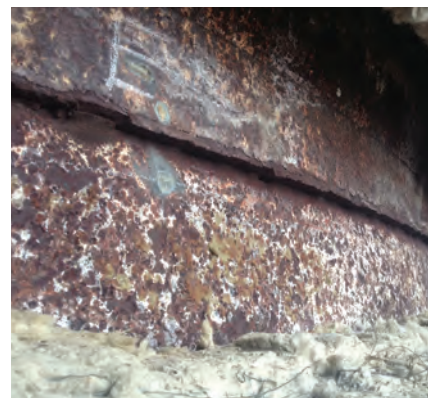
Grieta circunferencial en faldón
